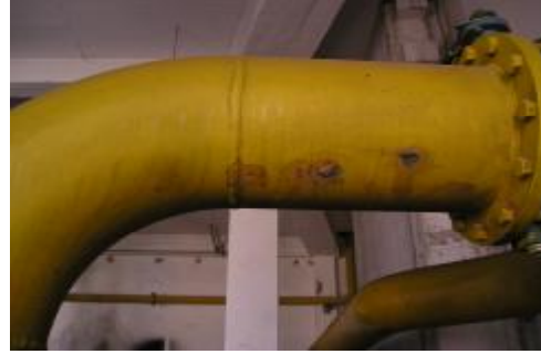
الشكل (4) تآكل ونخر في أحد أنابيب نقل الغاز الحيوي
