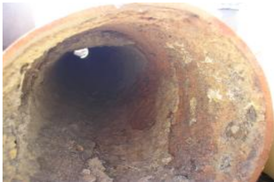
الشكل (6) ترسبات على الجدار الداخلي لأنبوب الغاز
