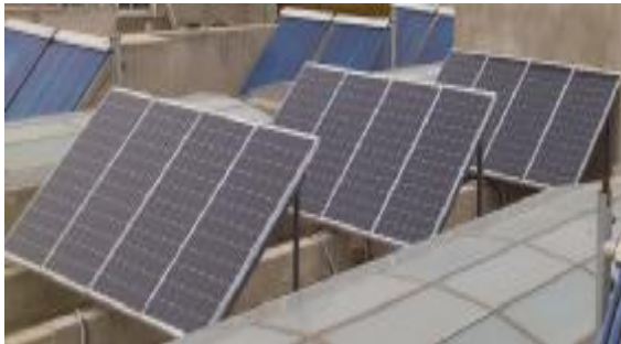
الشكل(13) يبيِّن ألواح الطاقة الشمسية للمشروع الذي نُفِّذَ على سطح البناء البيئي الأخضر باستطاعة 12[KW]
